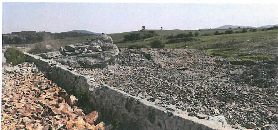
总干 6 标 9 号支洞弃渣场挡渣墙损坏
